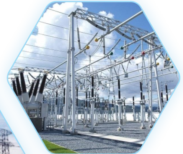
110kV变电站 110kV Substation
